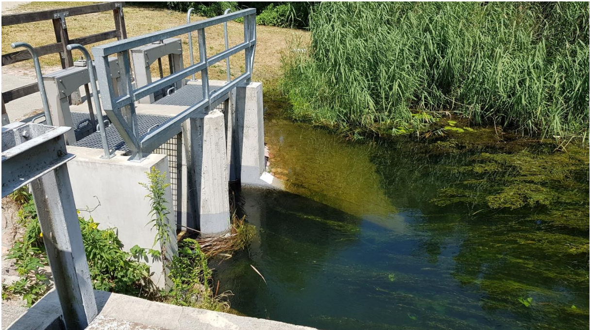
139. kép: Zátonyi-Duna zsilip a Sérfenyősziget alatti szakaszon.
